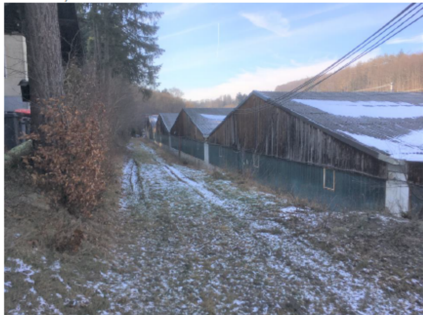
Blick auf den bestehenden Weg, der als private Verkehrsfläche ausgewiesen werden soll; Foto vom 10.02.2023
